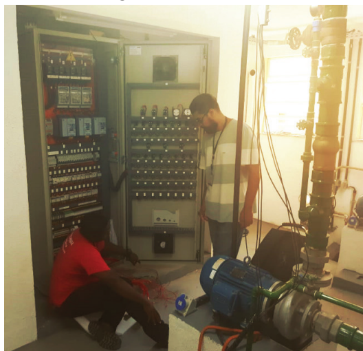
Automação do sistema de abastecimento de água potável, que teve reservatórios e cisternas reformados e instalações de novas bombas de recalque e sucção
